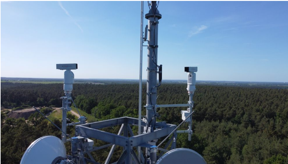
Die 200. IQ FireWatch Installation Deutschlands am Standort in Alt Garge in Niedersachsen (Bild: IQ Technologies for Earth and Space GmbH)
