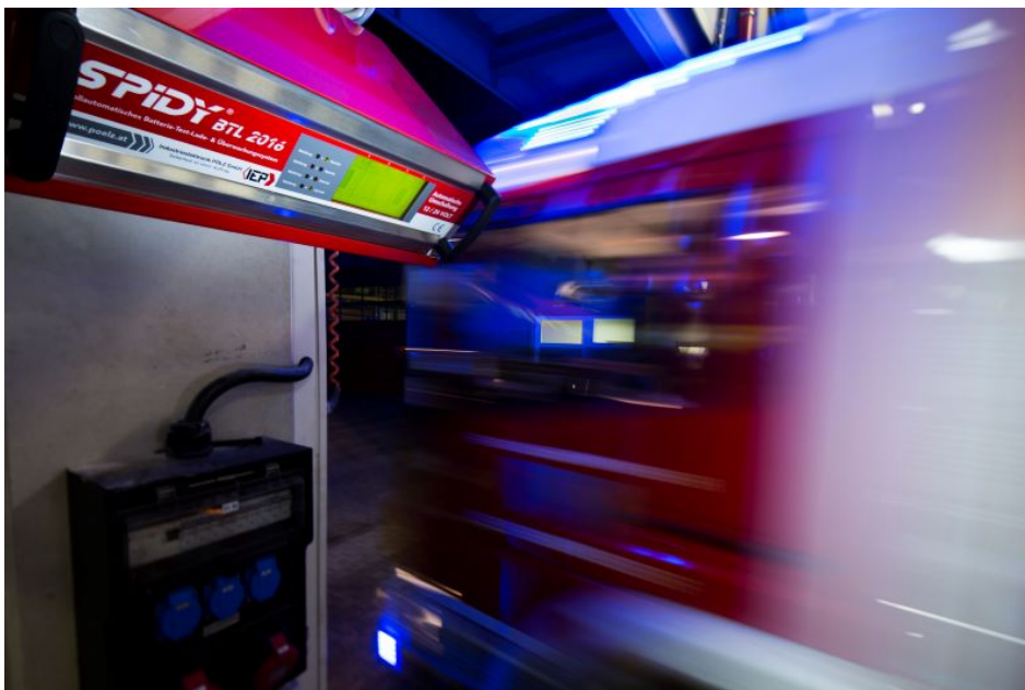
»BTL Powersingle 16A /25A« (links) für ein Fahrzeug und rechts ein »BTL 2016« für bis zu vier Fahrzeuge (Bild: IEP Pözl).
